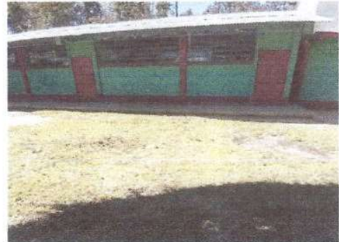
FOTO 2: Se observa el frente de 2 aulas que se han sustituir el piso cerámico, Módulo 2.
